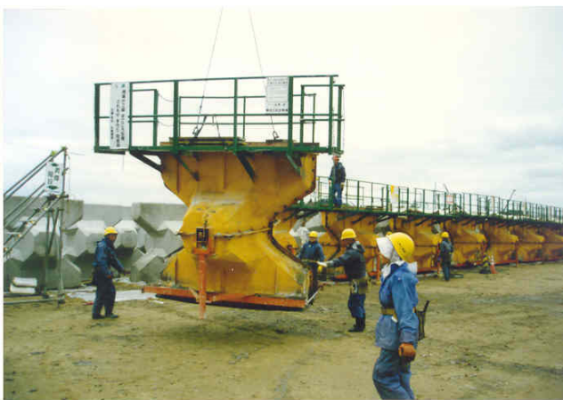
Photo No. 2: Déplacement d'un coffrage
