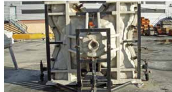
Coquilles en fibre de verre soutenues par une structure métallique
